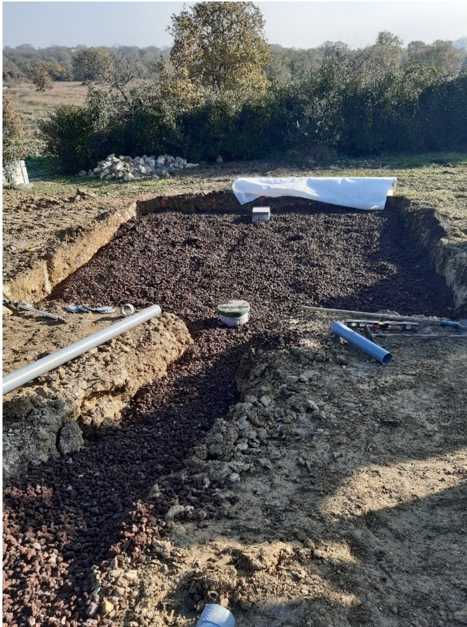
ANC (Assainissement Non Collectif) en cours d'installation © Communauté de Communes du Pays des Vans en Cévennes
